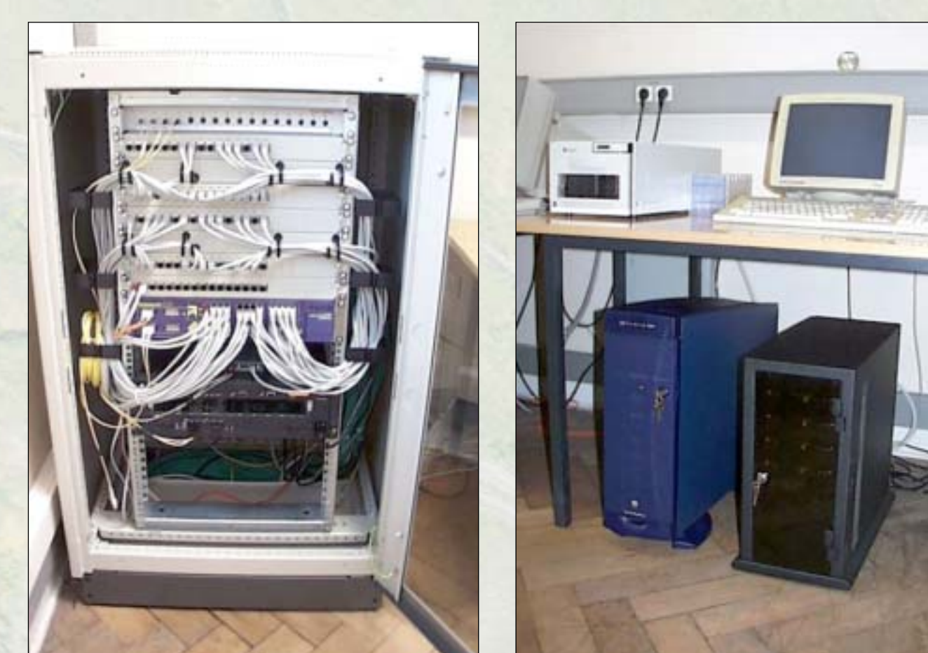
Abb. 10: Installation der aktiven Netzkomponenten (links) und des Kommunikationsservers (rechts).
